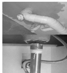
水供給配管漏れ / 水道管の水漏れ
